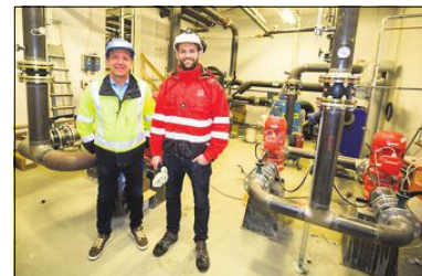
VARMESENTRAL: Det er fra dette rommet fjernvarmen sendes ut i Portalen. Anleggsleder Erik Knutsen (t.h.) og byggeleder i Arnt-Magne Torjuul kan ramse opp flere fordelene med en slik løsning.
