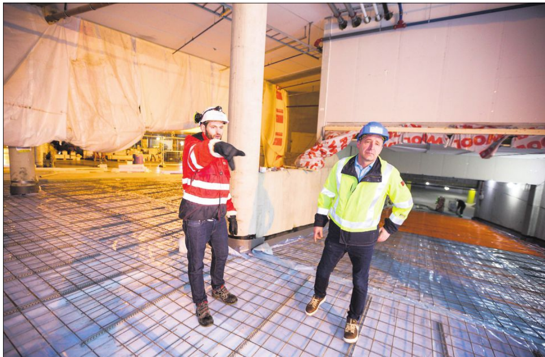
GRØNT: Anleggsleder i Veidekke, Erik Knutsen (t.v.), og byggeleder i Akershus Energi Varmer, Arnt-Magne Torjuul, har sørget for bruk av fjernvarme allerede under byggingen av Portalen. Det har gitt store miljøgevinsten. FOTO: TOM GUSTAVSEN
